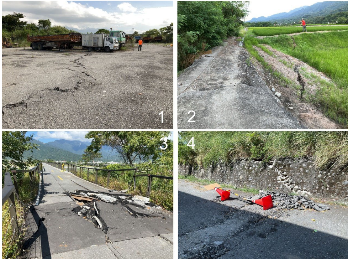
圖 27：917 關山地震及 918 池上地震地表破裂情形。照片 1：玉里斷層錯動，導致地面西側拱起，並形成一系列含左移現象的雁行破裂列；照片 2：地表破裂穿過河堤一路往北，稻田呈現東部抬升；照片 3：池上斷層由東向西逆衝並帶左移分量，導致舊玉里大橋東側橋墩左移拱起；照片 4：池上斷層由東向西逆衝，導致東側駁坎抬升數十公分（黃志遠拍攝）。
