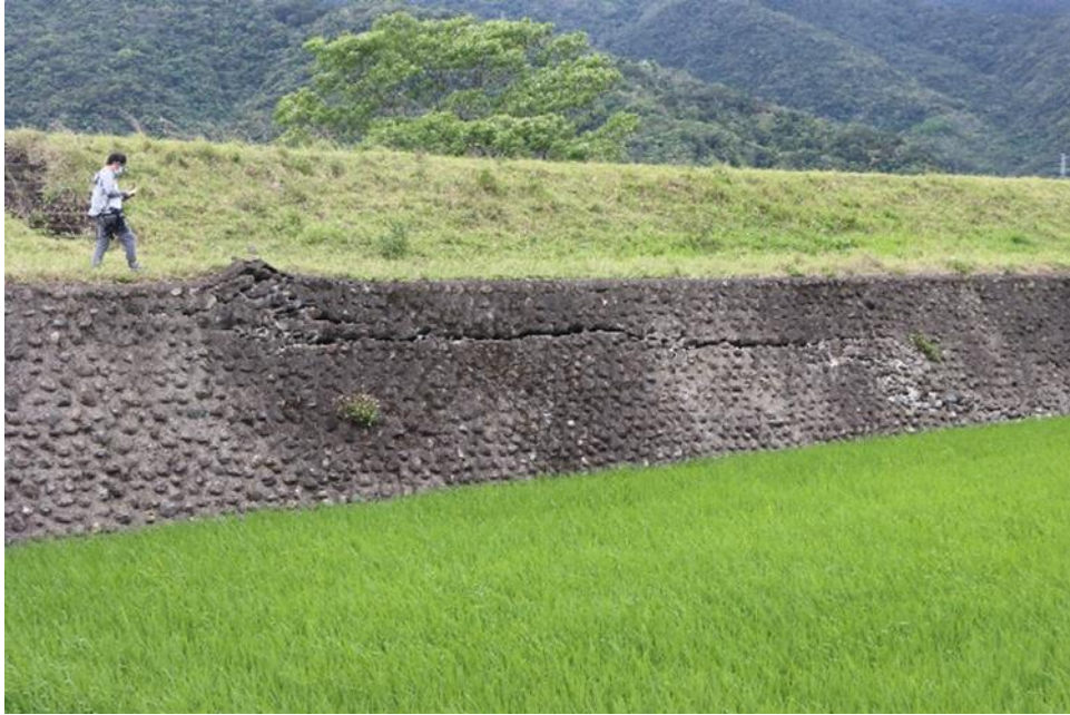
圖 16、富北地區田邊擋土牆有受壓拱起及破裂現象。
