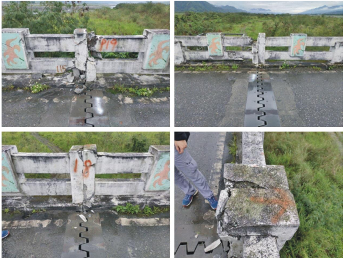
圖 24、高寮大橋東側，P18 至 20 欄杆與伸縮縫舊有潛移受搖晃擠壓產生新破損，橋下河床小規模破裂（向西北、向北拍攝）。
