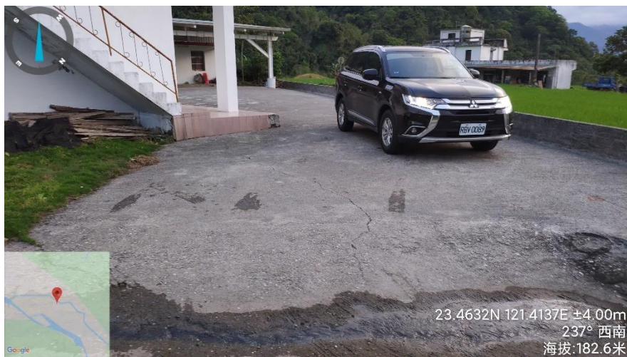
圖 21、德武地區奇美斷層附近，建物及地表局部破裂現象。
