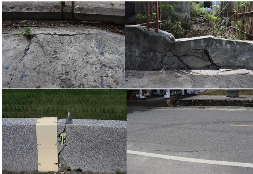
圖 19、池上鄉大坡池附近道路與土地公廟，過去成功地震造成地表破裂或人工結構物破壞之處，此次震後產生新的破裂現象。
