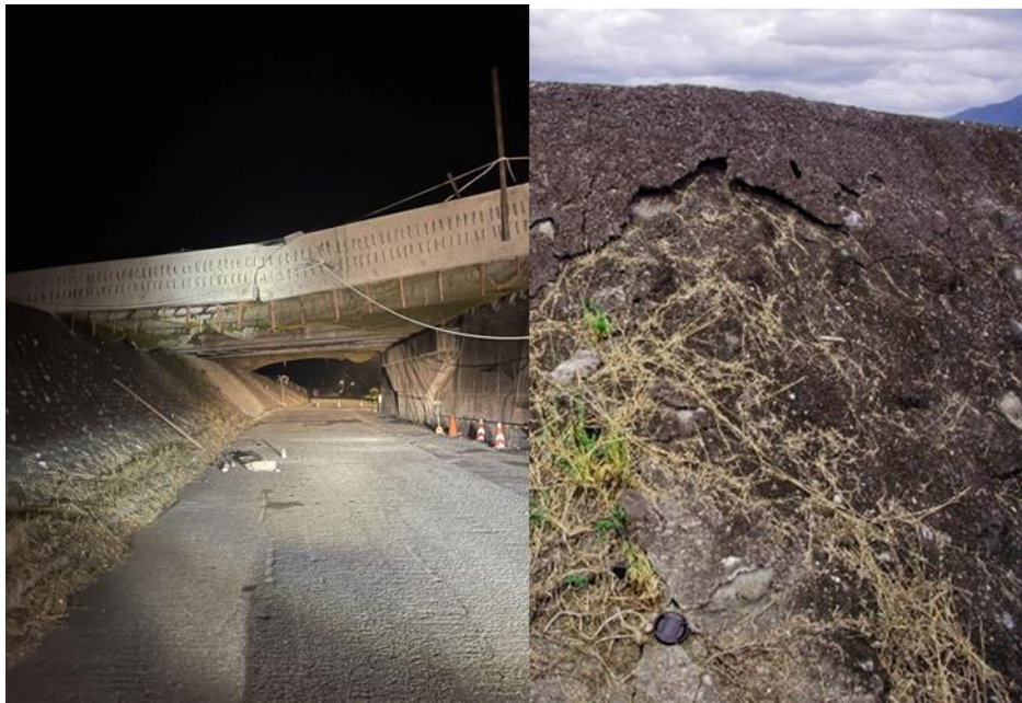
圖 31、玉興橋與側翻預力橋梁（旺財應用地質技師事務所提供），鄰近玉興橋的南側堤防受擠壓鼓起破裂。
