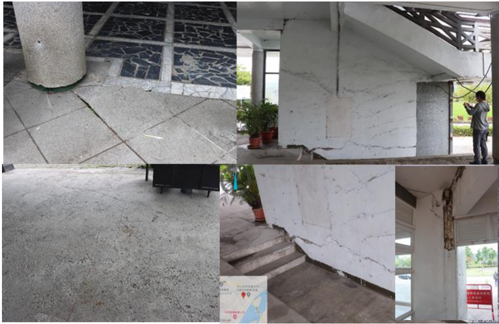
圖 20、瑞穗斷層跡附近，僅秀姑巒溪遊客中心人工建築物有結構破壞、地面磁磚拱裂現象。
