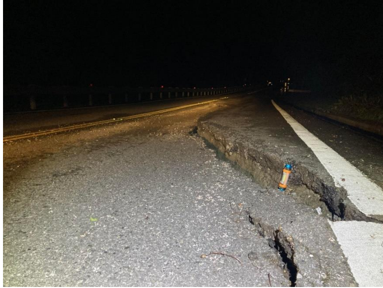
圖 28、玉長公路強烈地表加速度引起道路與人工建築物之結構破壞（旺財應用地質技師事務所提供）。
