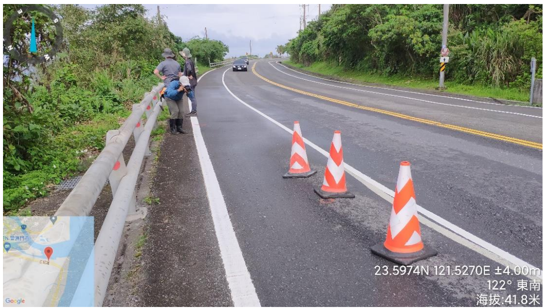
圖 23、豐濱地區奇美斷層線上，部分道路壓縮引起的地表局部破裂現象。
