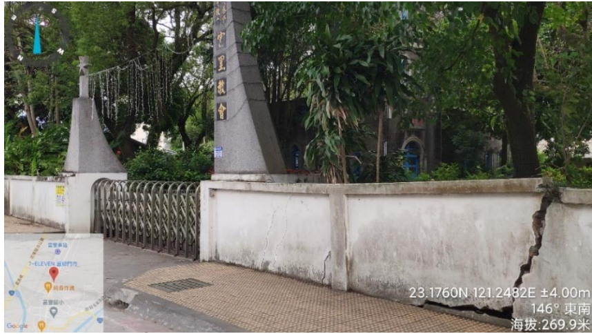
圖 13、富里鄉中山路富禮教堂圍牆及周圍地區有多處破裂及錯移現象。
