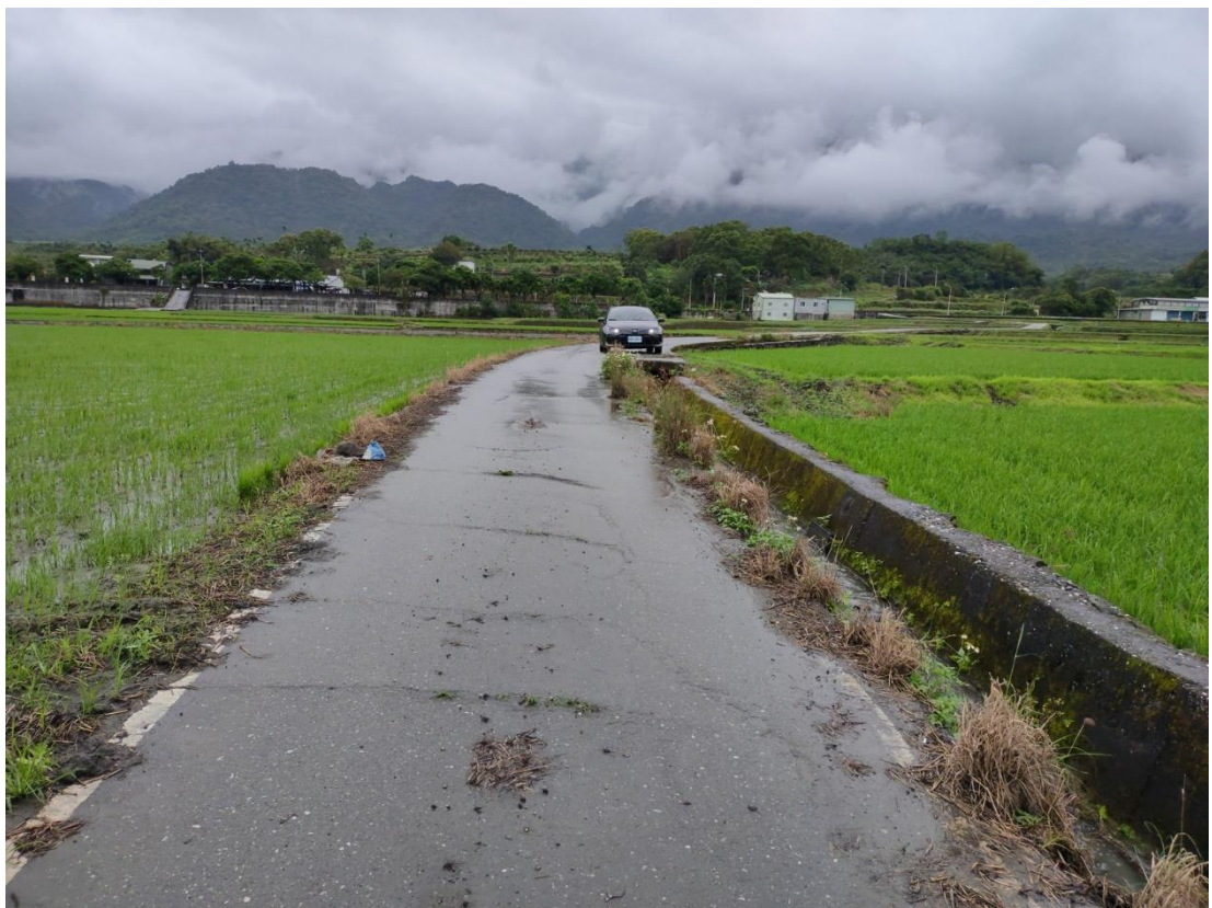
圖 12、麻汝附近農路上一系列擠壓拱起裂隙，恰位於池上斷層活動斷層地質敏感區範圍內，多數裂隙產生新擴張情形(向東拍攝)。
