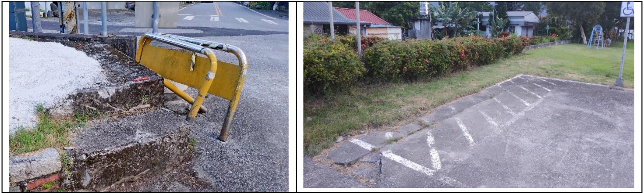
圖 34、月眉國小周圍拱裂，從校外道路裂至校內，新修補痕跡，而校門口則有地基拱裂新痕（黃志遠攝）。
