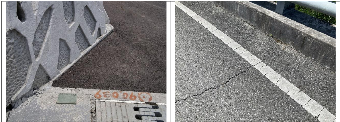
圖 35、左：箭瑛大橋東側橋頭輕微張裂（劉彥求攝）；右：中興大橋東側橋頭（黃志遠攝）。
