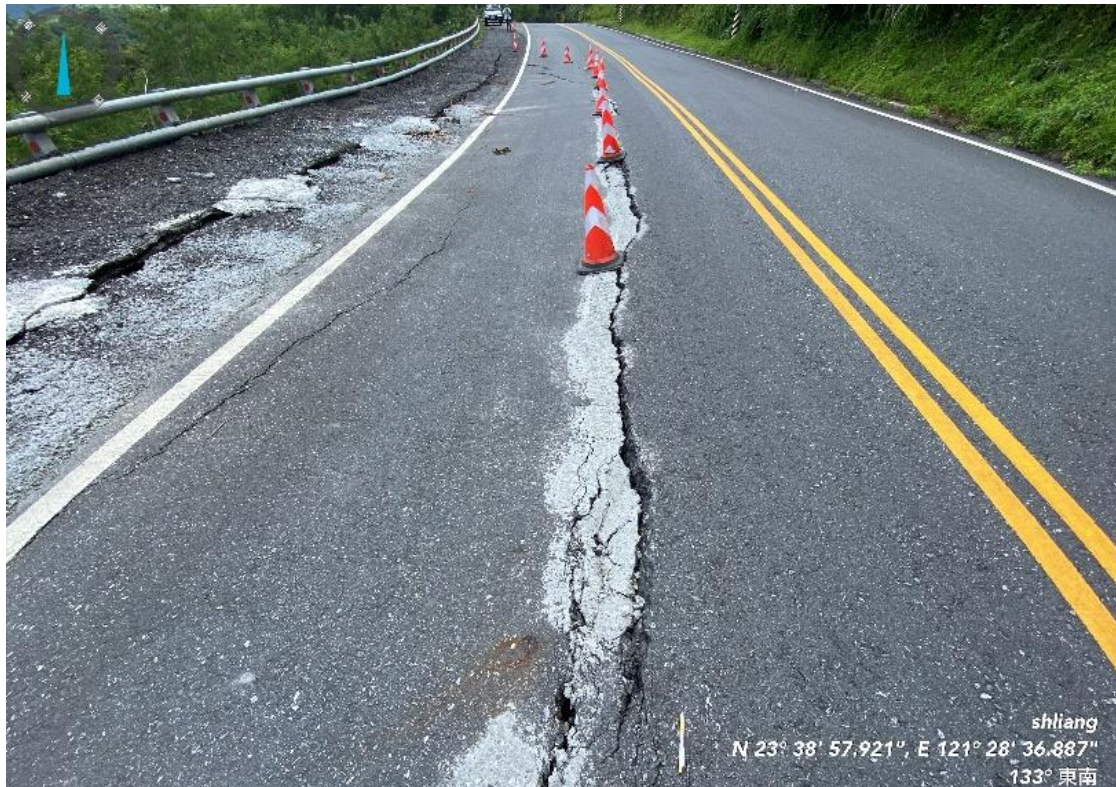
圖 33、光豐公路，道路於 0323 長濱地震後便有邊坡滑動現象，補強後於 0620 地震沿舊有破裂處再度破裂（梁勝雄攝）。
