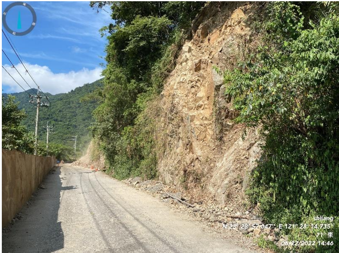
圖 32、瑞港產業道路（花 64 線）山崩事件（梁勝雄攝）。
