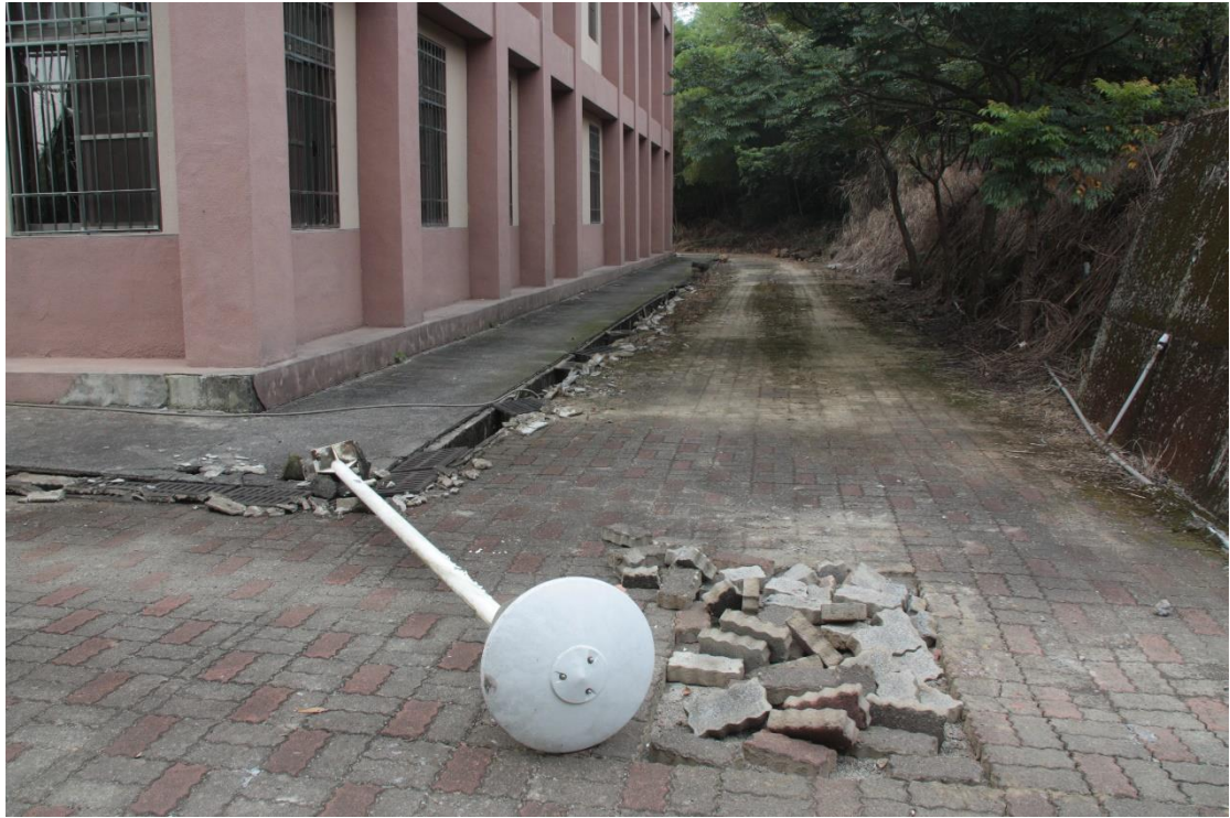
圖十一 鹿谷鄉公墓的主結構體與四周的地基連接處均可見開裂現象，四周地基均為相對下陷側。（攝於 102 年 6 月 4 日）
