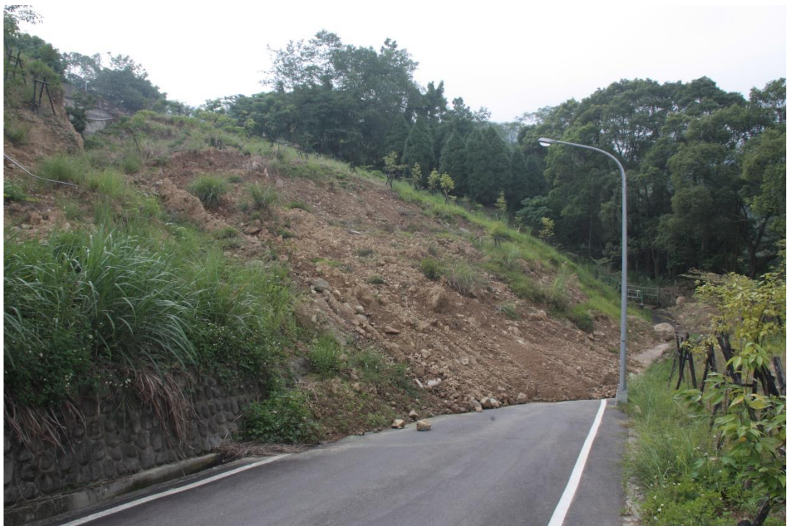
圖十二 鹿谷鄉公墓停車場下方之邊坡已滑動，並阻擋道路，範圍約 10 公尺寬。（攝於 102 年 6 月 4 日）
