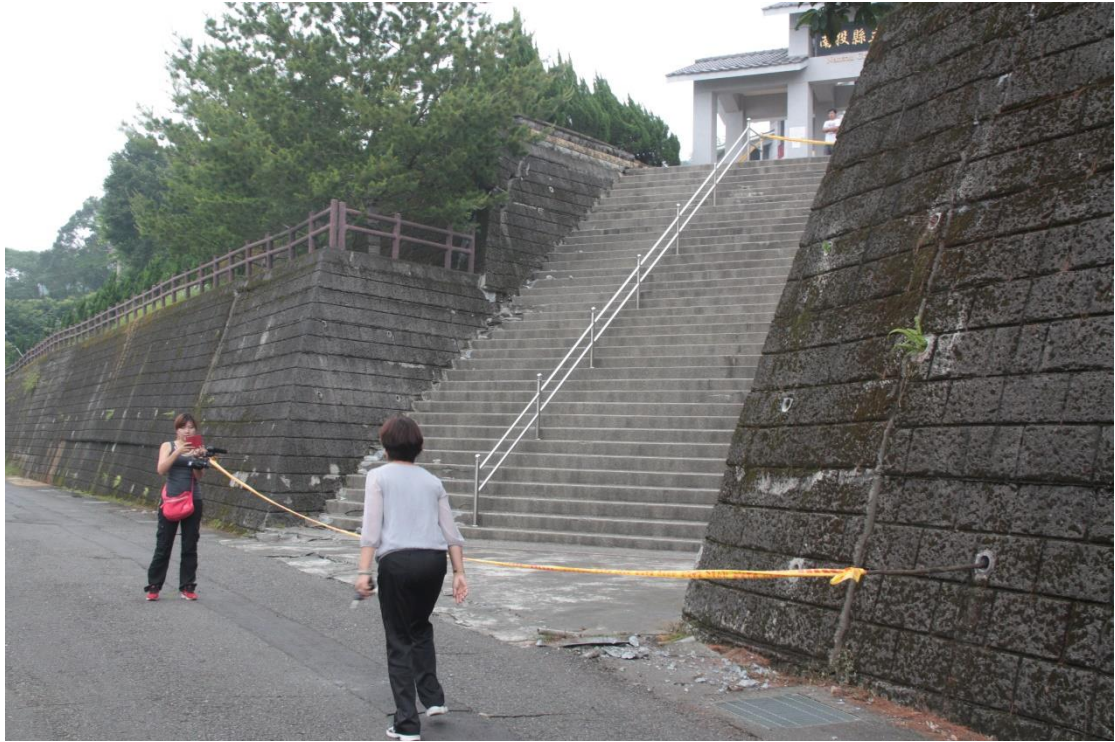
圖九 鹿谷國中的正門口為一陡坡，鹿谷國中位於一小丘之上，周圍設有擋土牆，本次地震該擋土牆有多處受損。（攝於 102 年 6 月 4 日）
