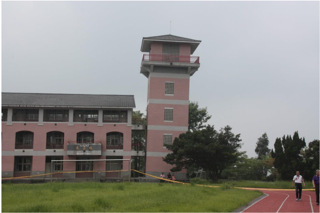
圖七 鹿谷國中的鐘樓在本次地震傾斜，並與主結構體脫離。（攝於102年6月4日）
