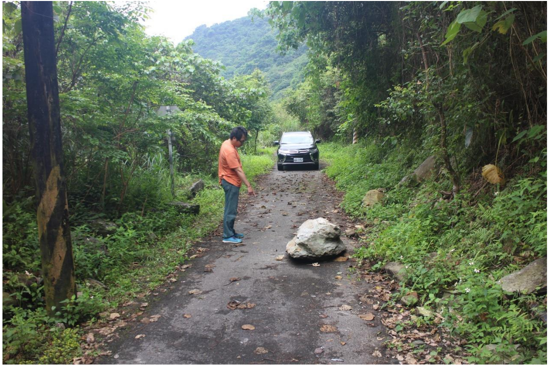
圖 3-18、龍澗道路震後落石掉落阻斷交通。
