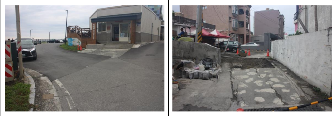
圖 3-1、七星潭地區本次地震後現場狀況。
