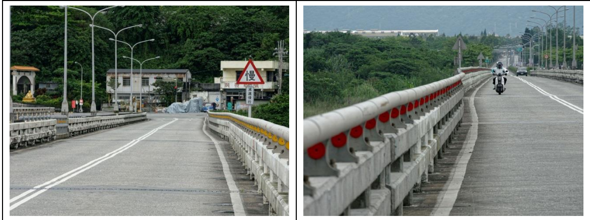
圖 3-9、本次震後花蓮大橋現況。
