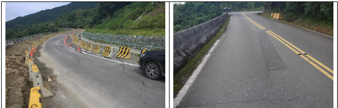
圖 3-14、193 縣道因強烈地震而發生路基滑動、路面破裂。 左圖攝於崩坎地區，右圖攝於崩坎北側，破裂沿先前修補位置再度產生。
