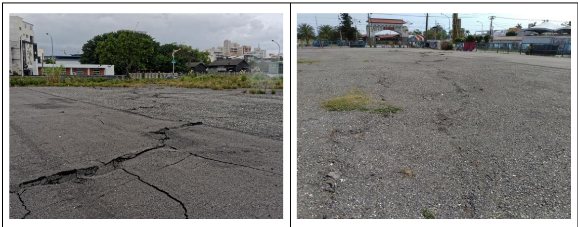
圖 3-8、東大門夜市北側一處空地的 0206 地震同震破裂現況。 本處破裂由圖 3-7 左圖一帶向北延伸至此，破裂或推擠規模在震後仍有持續增大趨勢，左圖約為向北拍攝，右圖為反方向向南拍攝。
