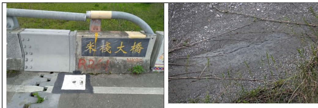
圖 22、點位 5 米棧大橋東側伸縮縫略見擴大，與橋下僅見輕微液化現象。
