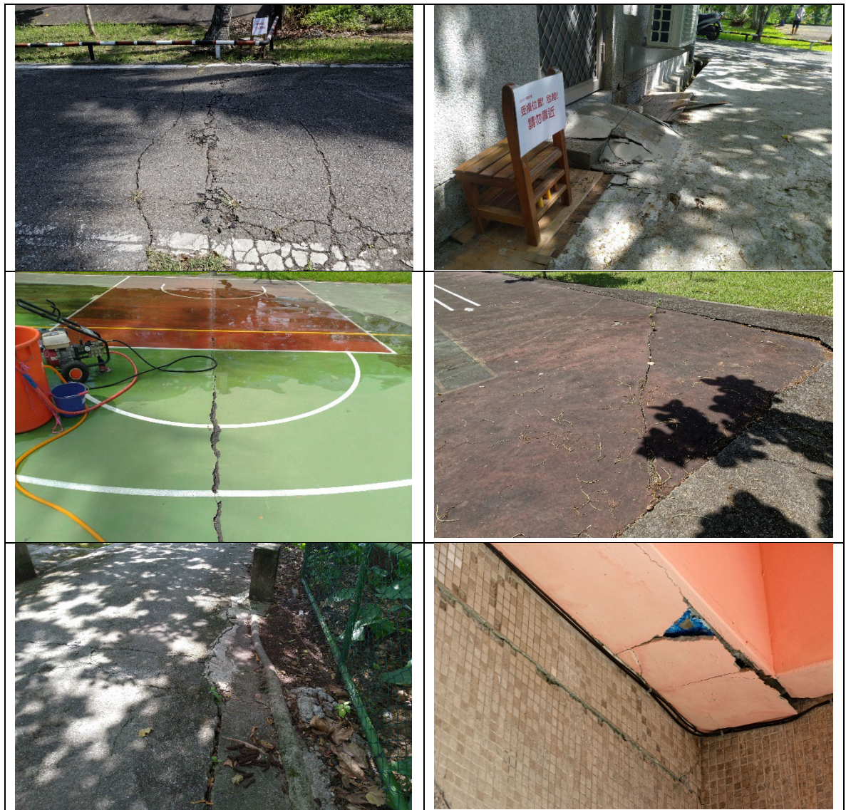
圖 24、點位 6，1：左上，側門柏油路拱起破裂、2：右上，房舍牆腳裂隙、3：左中，新操場中央數道裂隙、4：右中，舊操場舊有裂隙擴張、5：左下，南側邊坡既有裂縫略擴大、6：右下，教室新舊結構間梁柱裂隙。
