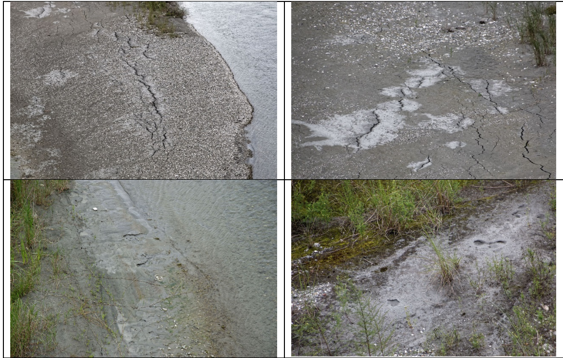
圖 11、點位 1 左上中興橋下北側沙洲之上伸張裂隙、噴砂孔與側潰相關現象。
