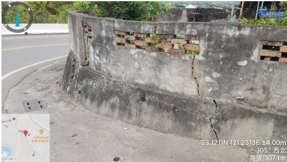
圖 18、池上斷層之上盤，部分區域可見到壓縮引起的地表局部破裂現象。
