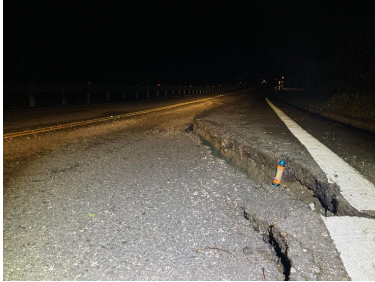
圖 28、玉長公路強烈地表加速度引起道路與人工建築物之結構破壞 (旺財應用地質技師事務所提供)。
