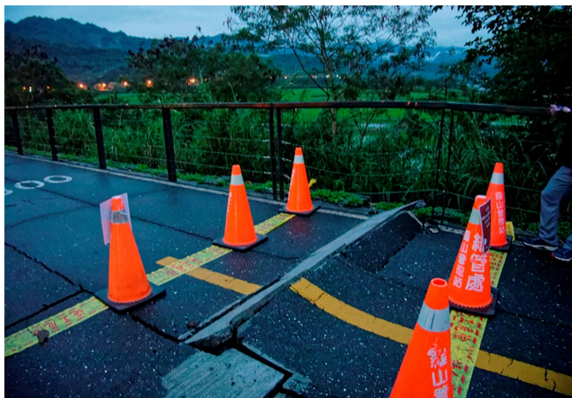
圖 15、玉里舊鐵橋東側，橋梁表層柏油受擠壓撓曲。
