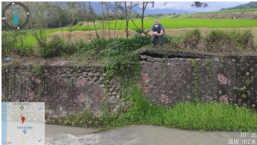
圖 14、電光地區水圳旁人工堤受到擠壓，拱裂現象加劇。
