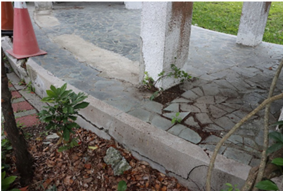
圖 17、萬安社區道路旁矮牆輕微擠壓鼓起破裂現象，道路對側牆面亦可發現輕微裂痕。
